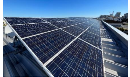
大阪南営業所 太陽光発電設備(2013年)
